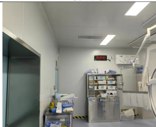
机房内排风+进风系统
